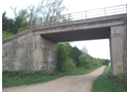
Etat actuel du pont à situé à 4 km 150 dans le descriptif du fascicule du 2ème bureau français (Photo N.Lombard)
