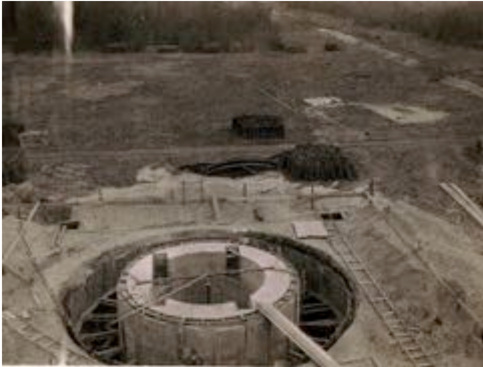
Fig. 17 : Tête de puits N° 2 Sud.
